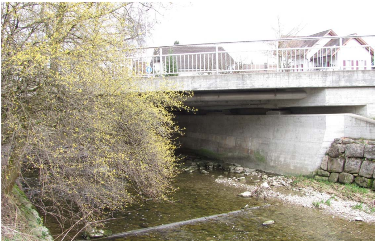
Abb. 5. Brücke Wildstrasse: selbst bei niedrigem Wasserstand ist die Verbindung längs des Gewässers für erdgebundene Tiere nur schwer möglich, da das Wasser bis an die Ufermauern reicht.
